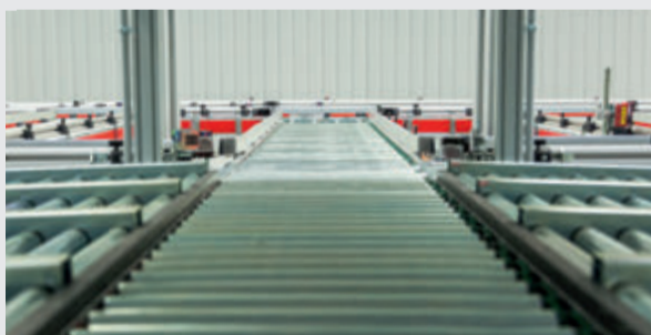
Schon während der Bauarbeiten von LIST BAU Bielefeld wurde das vollautomatische Kleinteillager montiert (hier die Fördertechnik).
