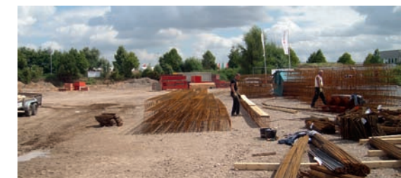
Die Arbeiten am neuen, 10 700 m 2 großen Möbelmarkt in Dormagen laufen auf Hochtouren
